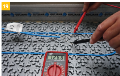
19 Provéřte celkový odpor vodiče a zapište do předávacího protokolu.
